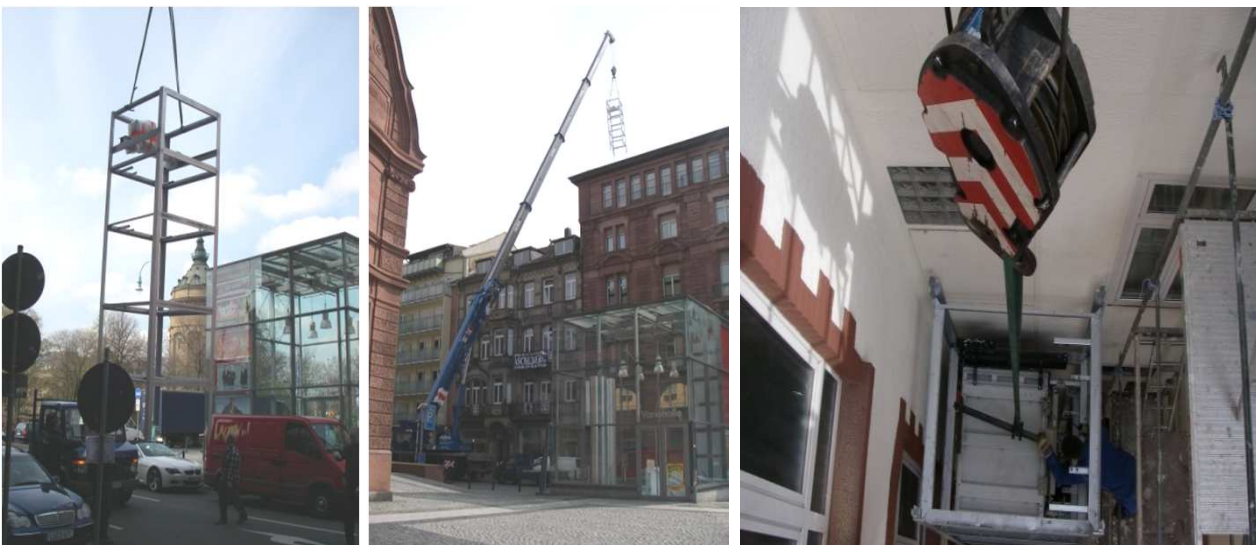
Das 18 m hohe Schachtgerüst wird über die Häuserfront zur Montage in den Hinterhof gehoben.
