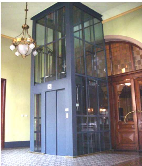
Aufzug im Eingangsbereich
